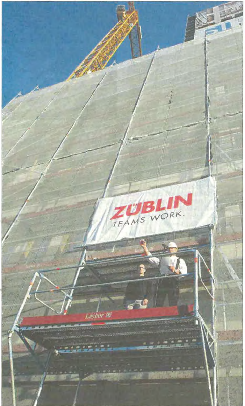
Die Bauarbeiten klappten wie am Schnürchen: Die Handwerker feierten gestern Richtfest für das Hochhaus am Bahnhof. FOTO: TRINKHAUS
