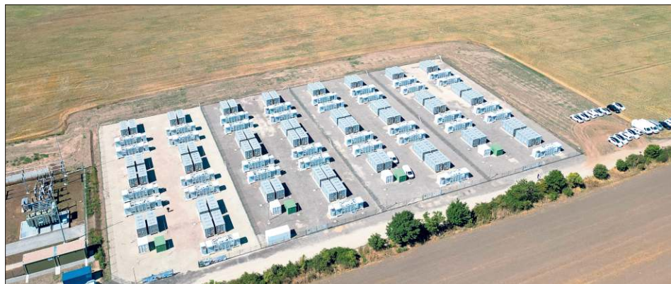
In Leuna steht einer der größten Batteriespeicher in Deutschland: Er kann rund 500 Megawattstunden überschüssigen Wind- und Sonnenstrom aufnehmen und ins Netz einspeisen: den durchschnittlichen Tagesbedarf von rund 125.000 Haushalten.
